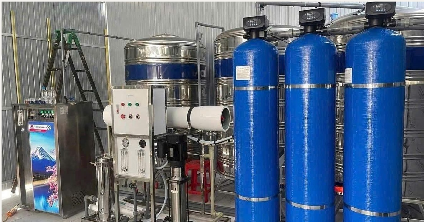
FIG. 05 — CỘT LỌC COMPOSITE, MÀNG RO, TỦ ĐIỆN ĐIỀU KHIỂN VÀ MÁY ION KIỂM
